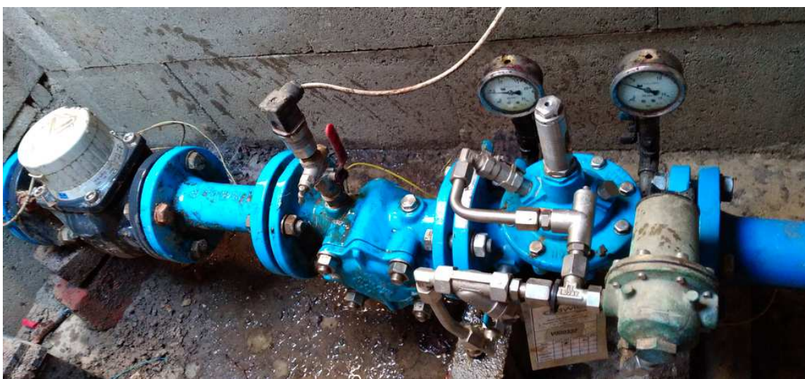
Obrázek D.6: Ukázka vodoměrné šachty U klenot
