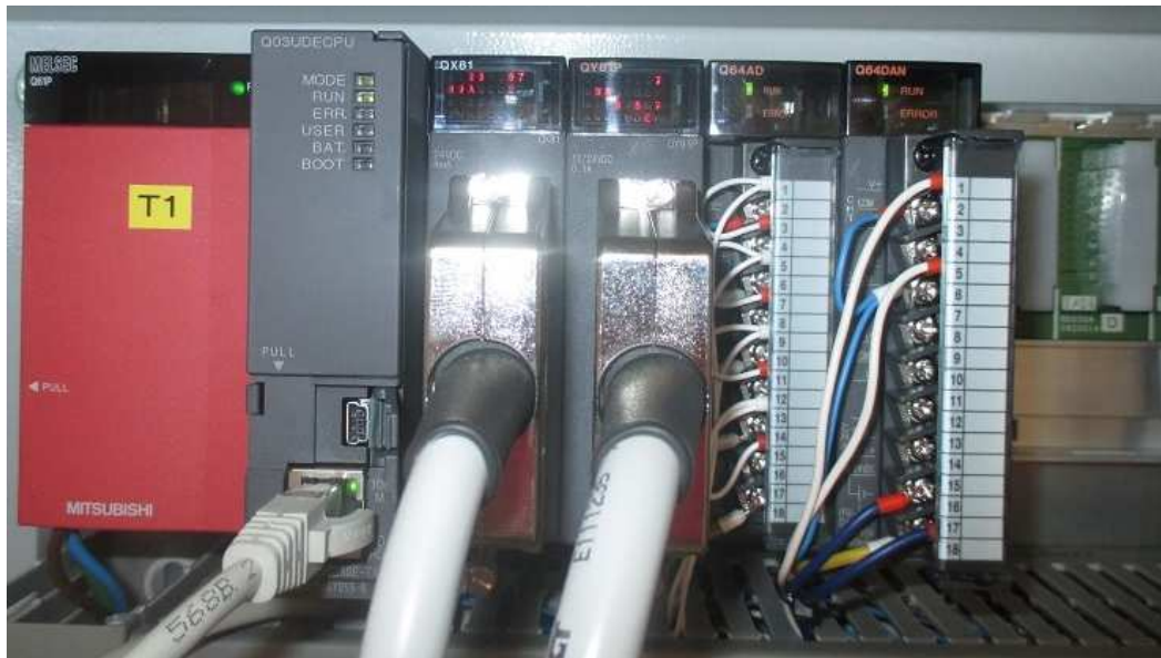
Obrázek 3.2: Realizovaný řídicí komplex v rozváděči
