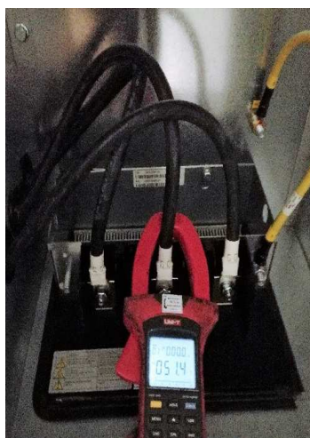
Obrázek 4.15: Měření proudu na vstupu měniče
