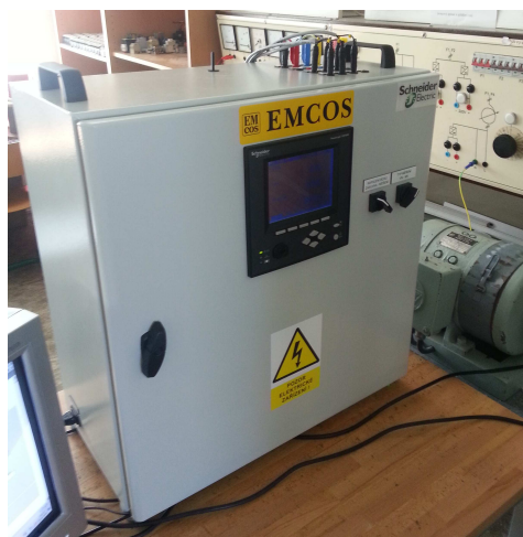
Obrázek 3.6: Přenosný rozváděč pro měření kvality elektrické sítě
