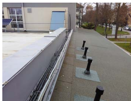
(b) vedená kabeláž po střeše
