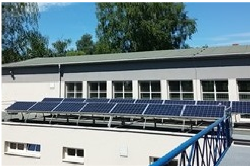
Obrázek 2.1: Fotovoltaická elektrárna v Sezimově Ústí II
