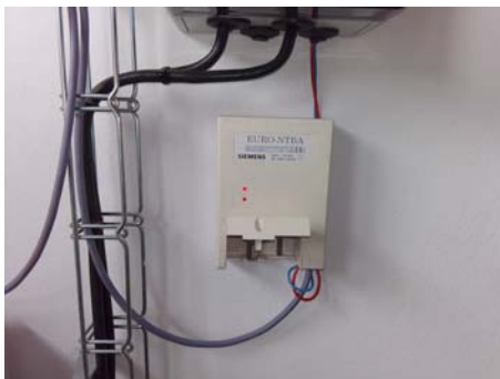
Obrázek 3.4: Umístěný napěťový sensor v akumulátorovně
