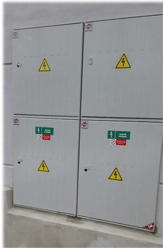
Obrázek 2.2: Rozvodné skříně na stěně objektu
