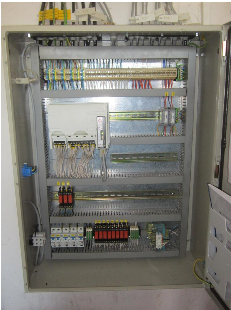
Obr. 2 Stávající rozvaděč MaR
