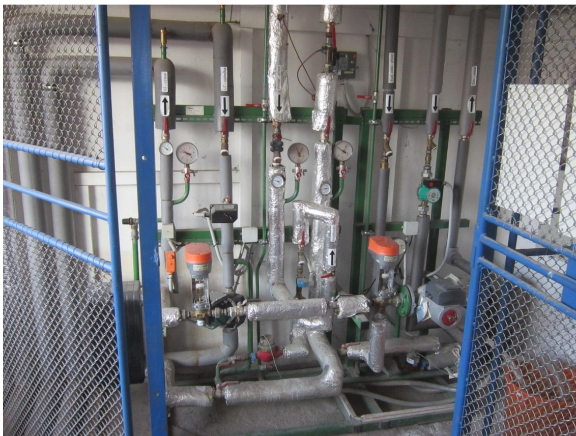
Obr. 1 Současný stav DPS
