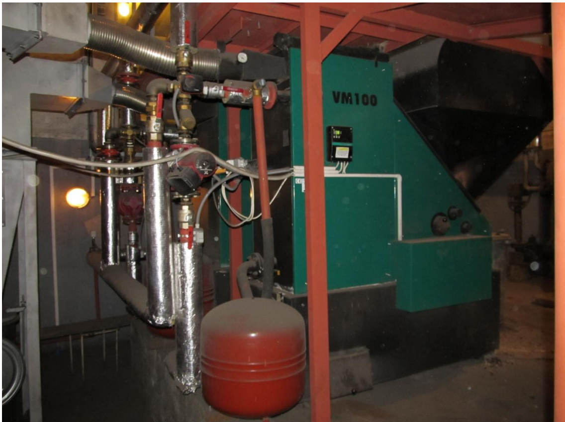
Obr. 20: Kotelna, Kotel VM100
