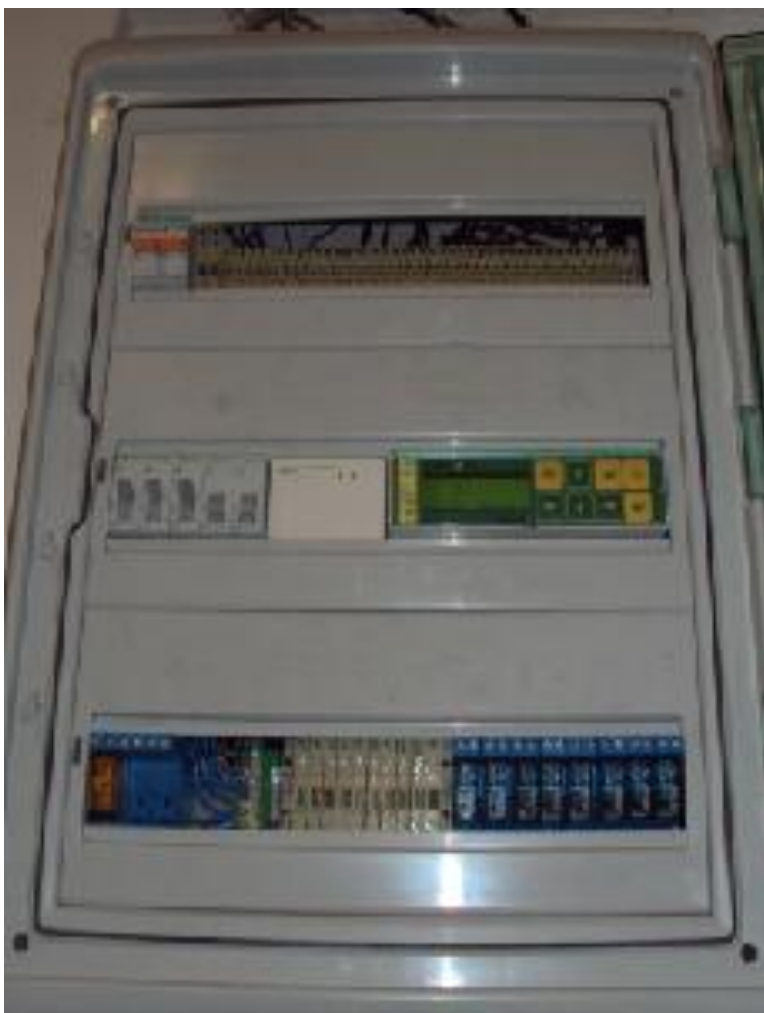
Obrázek 10: Foto rozvaděčová soustava
