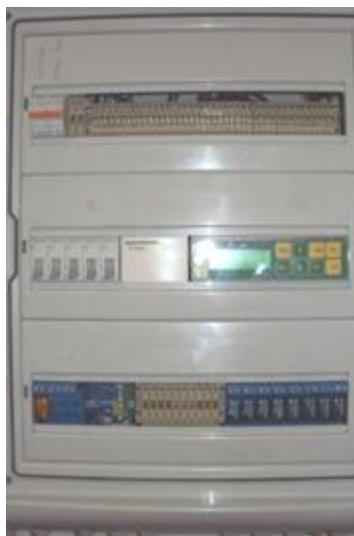
Obrázek 11: Osazená rozvodová skříň
