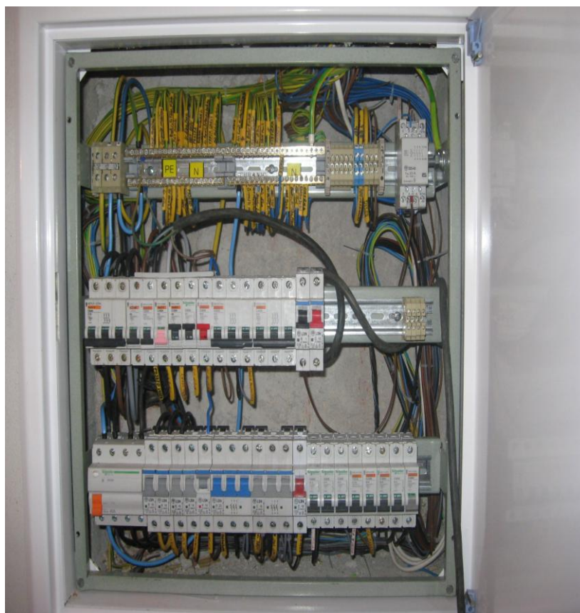
obr. 14 Hlavní rozvaděč v přízemí
