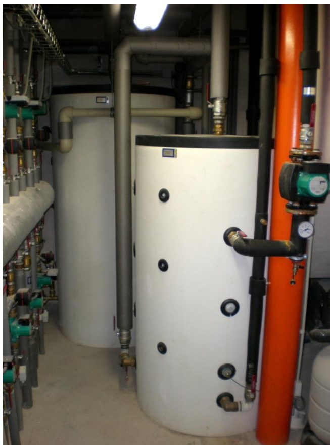
Obr. 16: Akumulační nádrž Regulus PS 800 a HSK 1000
