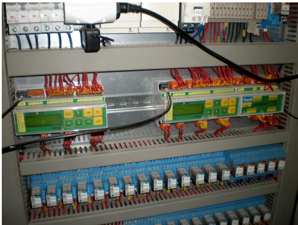
Příloha č. 24: Zapojená AMiNi4DS v rozváděči
