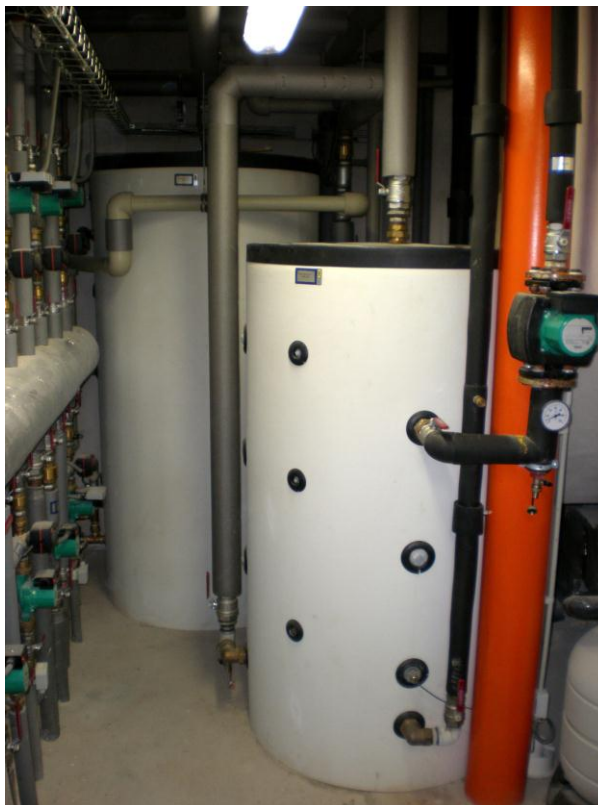
Příloha č. 23: Akumulační zásobníky v prostoru kotelny ekofarmy
