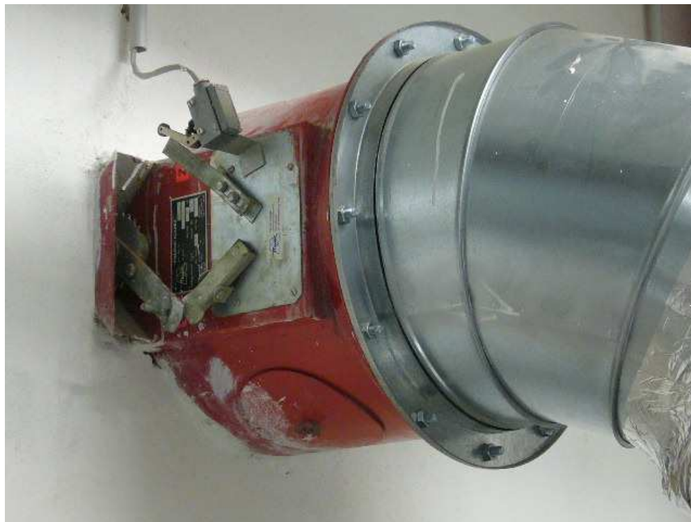
Obr. 32 Požární klapka v objektu Společenského centra
