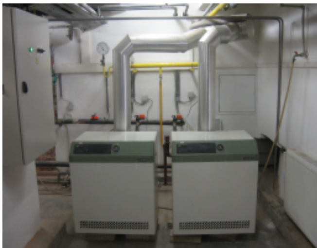
Obr. 3 Plynová kotelna s dvěma kotly VIADRUS G34-50 v levo je vidět elektro rozvaděč
