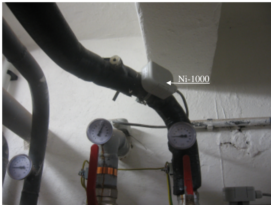
Obr. 7 Teplotní čidla Ni-1000 pro PLC a klasické bimetallové teploměry
