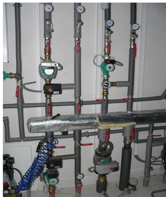
Obr. 21 Ventily umístěné na rozvodech TUV
