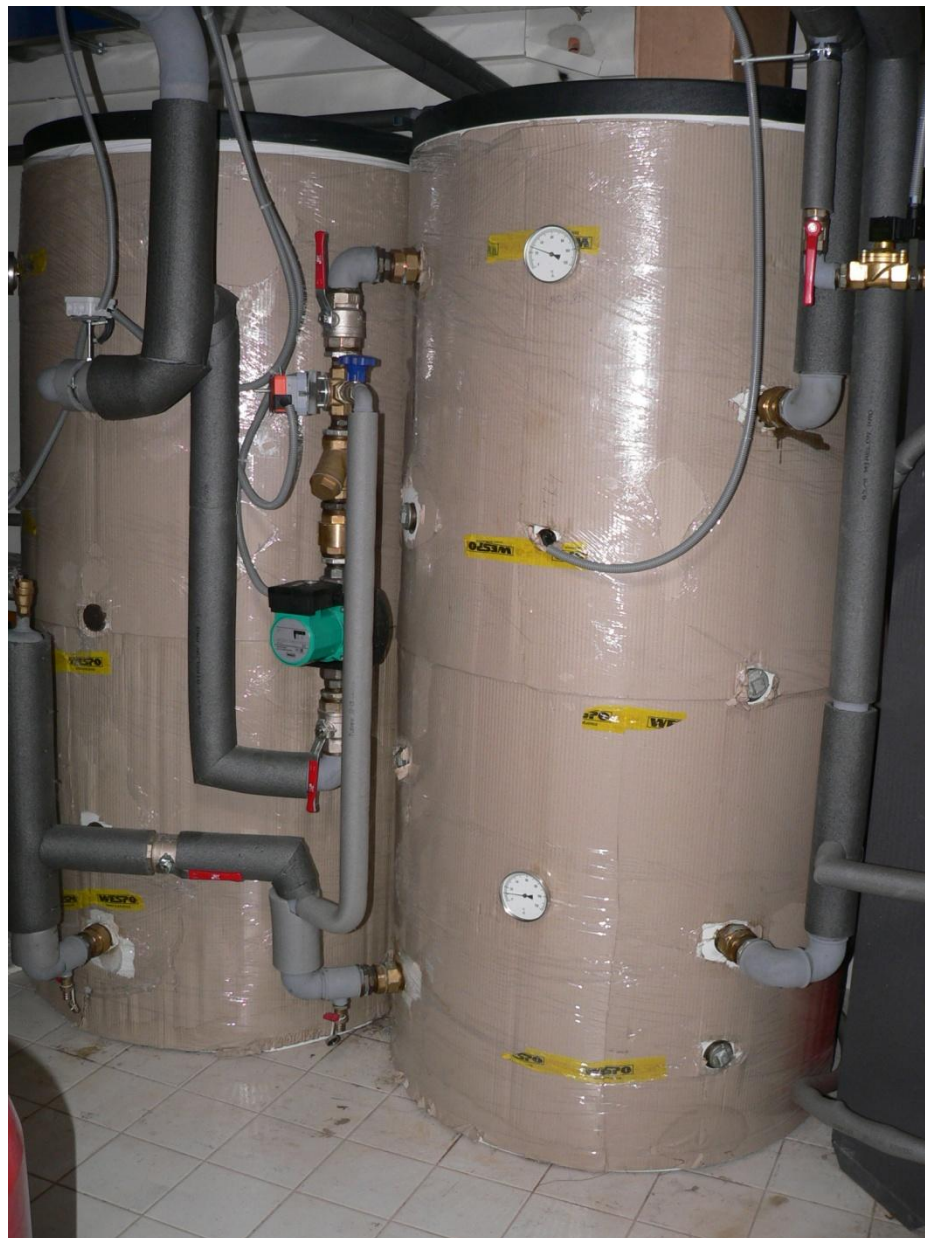
Obr. 14 Akumulační nádrže v objektu
