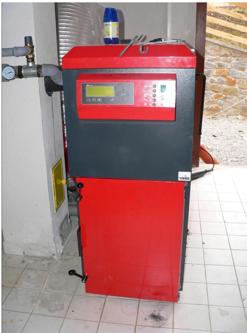
Obr. 5 Foto kotle Verner v objektu
